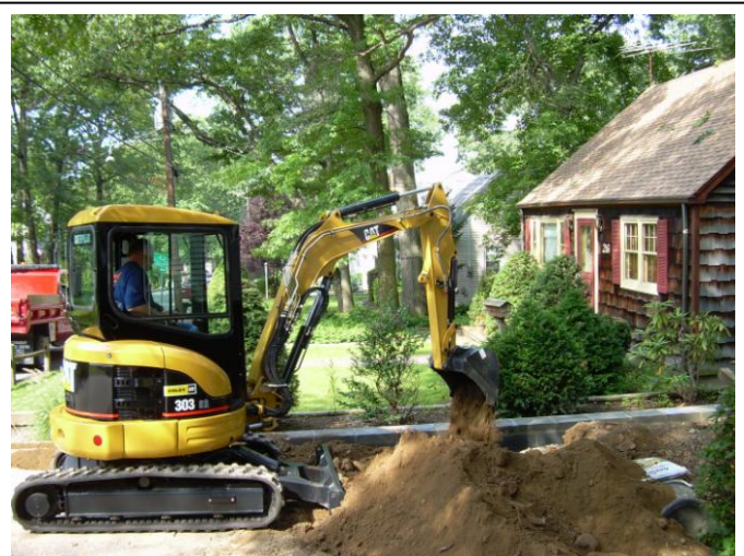
Excavadoras como esta van a ser usadas en el proyecto siempre que exista espacio para ello.
